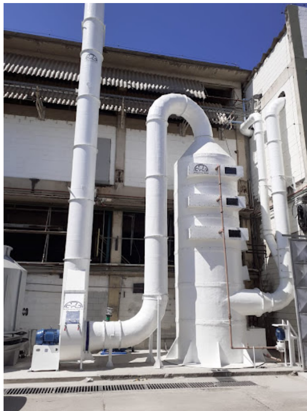
Figura 13 – Lavador de gases instalado em conjunto com um exaustor
