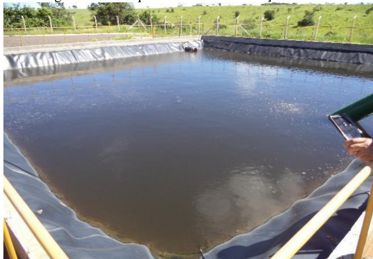
Figura 10 – Tanque de contato com adição de cloro.
