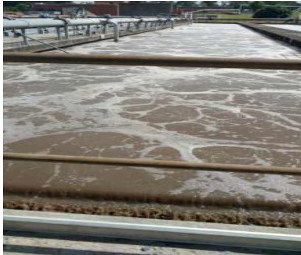
Figura 16 – Tanque de aeração da ETE Sugar Creek .
