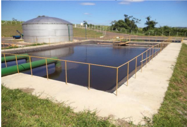
Figura 9 – Decantador secundário e tanque digestor de lodo (inox).
