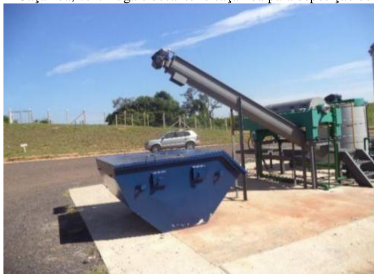
Figura 12 – Caçamba, centrífuga e decanter e caçamba para deposição de lodo seco.
