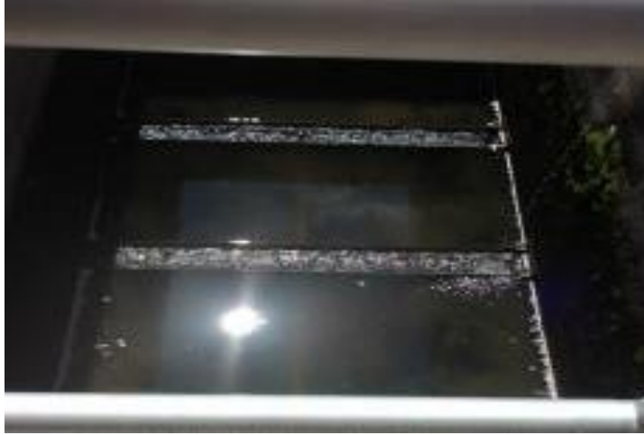
Figura 18 – Tanque de filtração com carvão antracite da ETE Sugar Creek .
