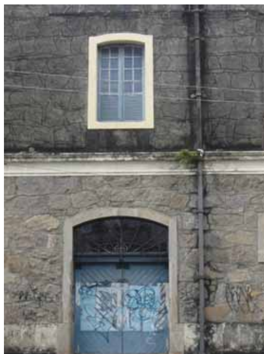
Figura 153. Detalhe que mostra o abandono e o mal cuidado com o prédio do grupo E. Fonte: Arquivo pessoal.
