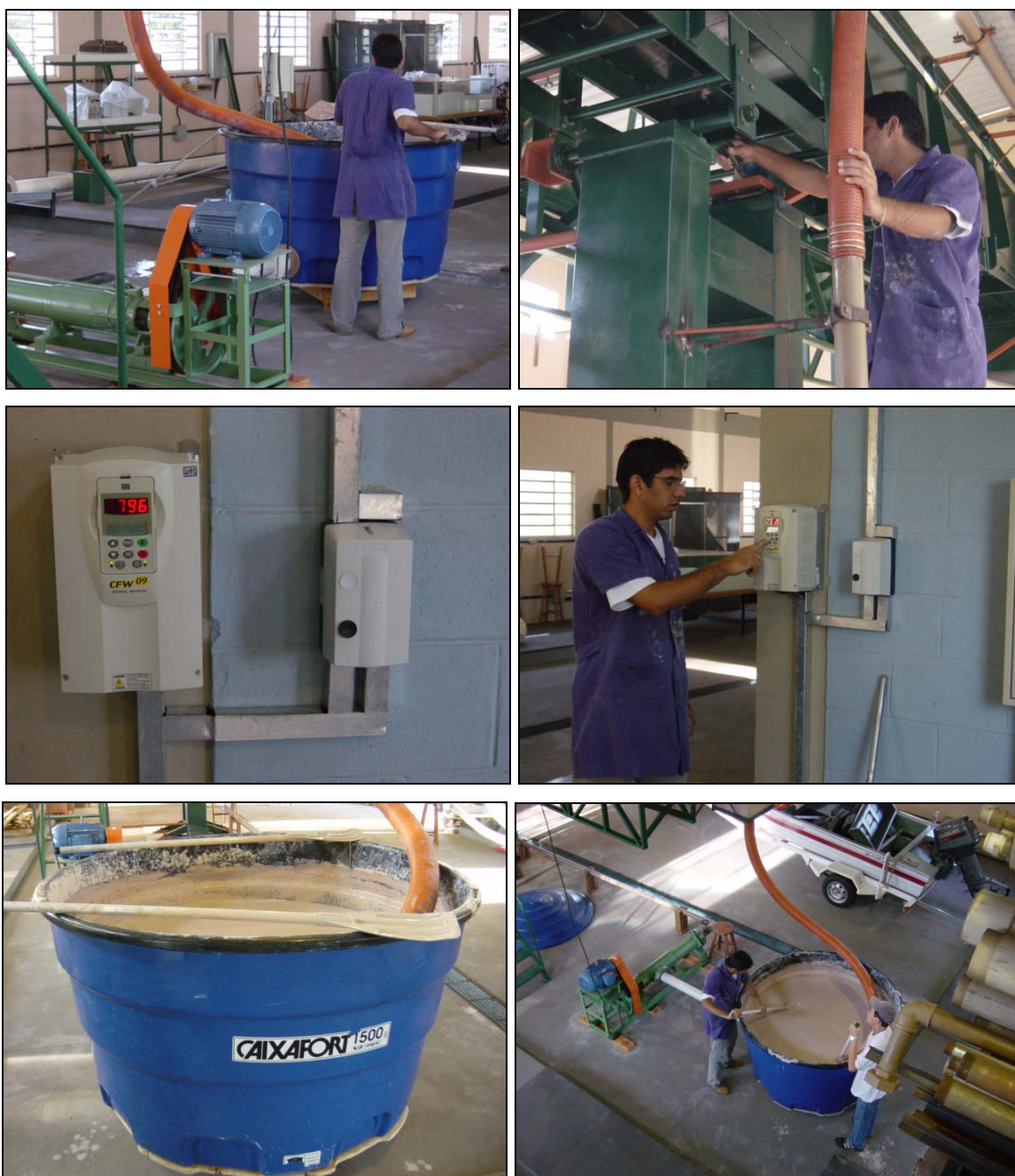
Figura 78 – Detalhe da bomba helicoidal – 7,5 cv (figuras superiores), inversor de frequência digital para controle de vazão (figuras intermediárias) e reservatório inferior para armazenamento das misturas (figura inferior).
