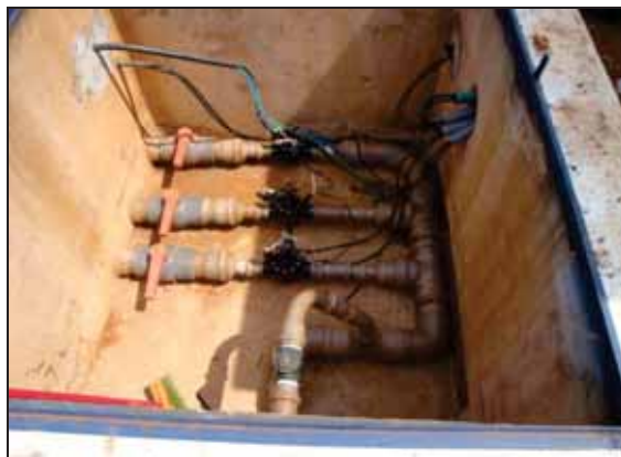
Figura 25. Foto da caixa com as eletroválvulas programadas para enviar o efluente intercaladamente aos alagados construídos.
