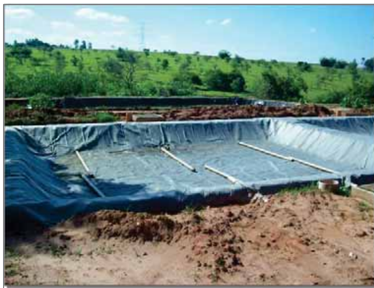
Figura 22. Leitos dos alagados construídos da ETE Tibiriçá.
