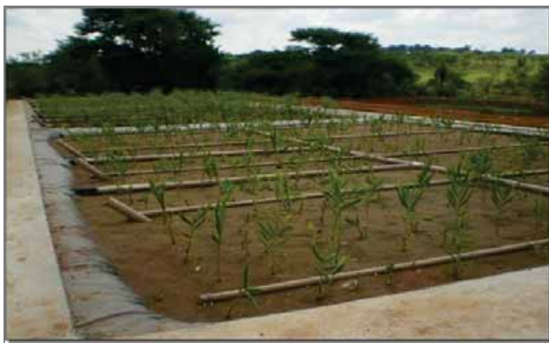
Figura 23. Vista dos alagados construídos com as tubulações drenantes superficiais e cultivo com macrófitas emergentes.
