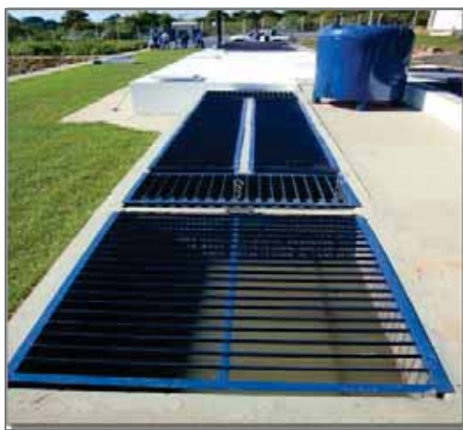
Figura 17. Foto da caixa de desarenação do esgoto da ETE Tibiriçá.
