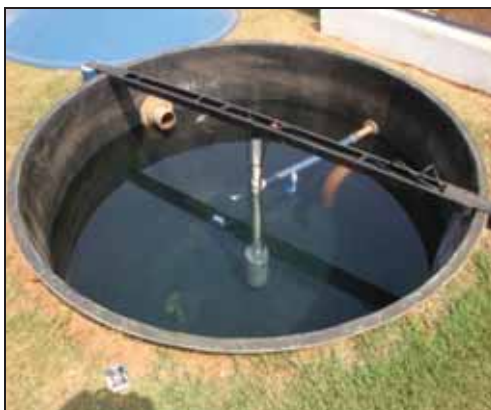
Figura 24. Foto da caixa de passagem do efluente do filtro anaeróbio para os alagados construídos.
