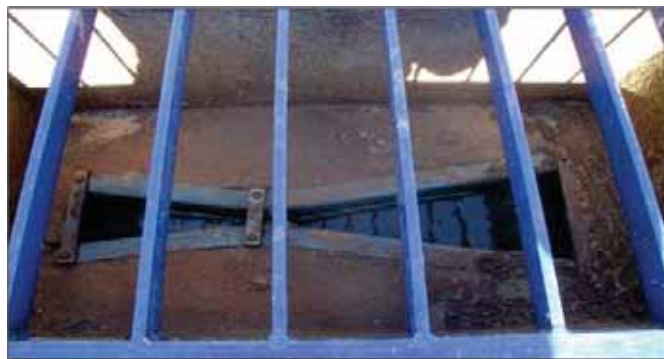
Figura 18. Foto da Calha Parshall da ETE Tibiriçá.
