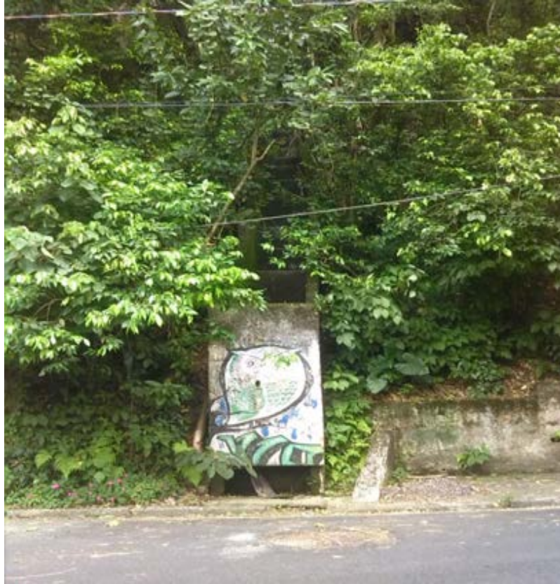
Figura 21 - Boca de lobo ao final da escada hidráulica
