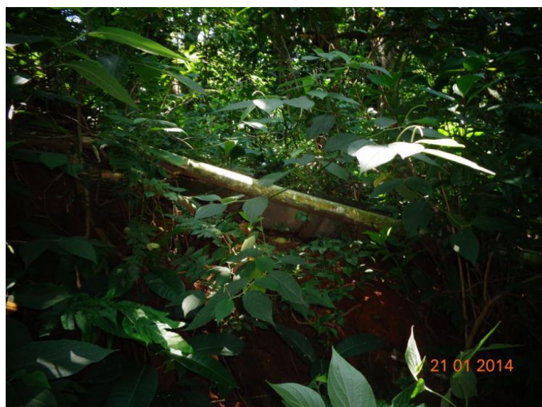
Figura 19 - Detalhe da ruptura localizada, que deixou a canaleta descalçada
