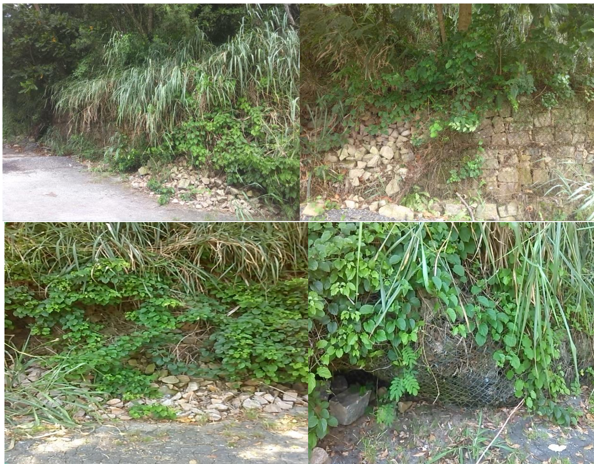
Figura 20 - Detalhes da ruptura da estrutura de arrimo
