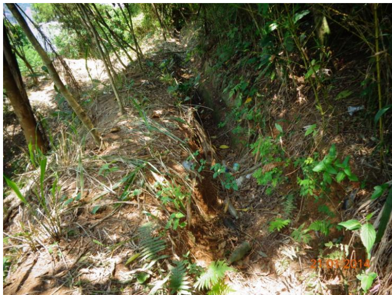
Figura 18 - Canaleta de escoamento obstruída por folhagens e resíduos
