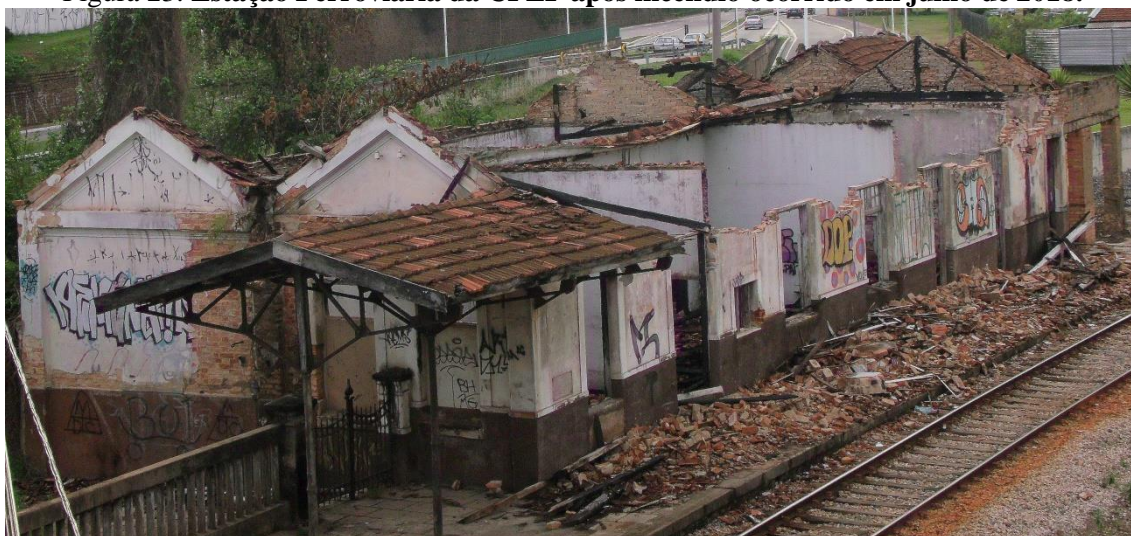
Figura 23. Estação Ferroviária da CPEF após incêndio ocorrido em julho de 2018.
