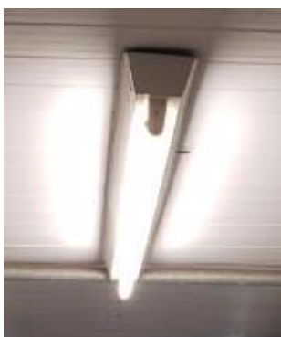
Figura 26 - Luminária de Sobrepor Fluorescente
