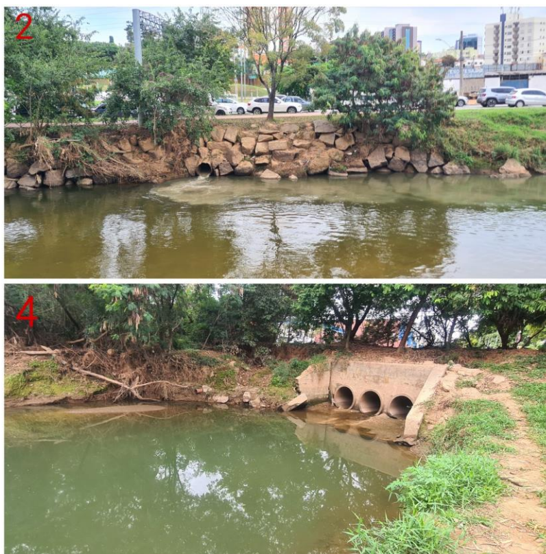
FIGURA 09 – Possível lançamento irregular: Registro fotográfico 13/06/23
