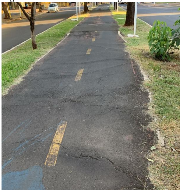
Figura 15 – Trechos com irregularidades.
