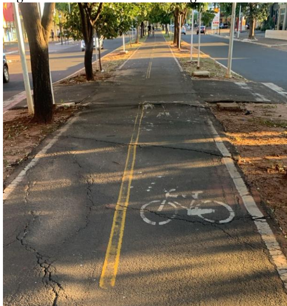
Figura 14 – Trechos com irregularidades.
