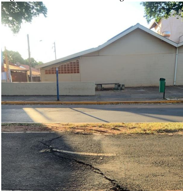
Figura 21 – Trechos com irregularidades.
