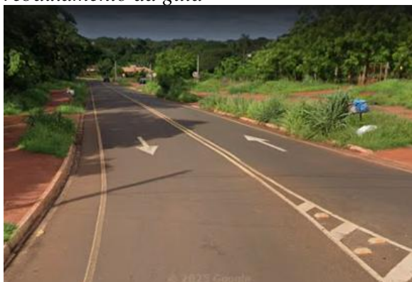
Figura 37 – Cruzamento da ciclovía na via sem a devida interseção das faixas e rebaixamento da guia
