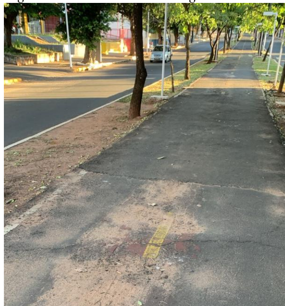
Figura 18 – Trechos com irregularidades.
