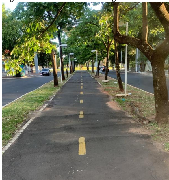
Figura 16 – Trechos com irregularidades.
