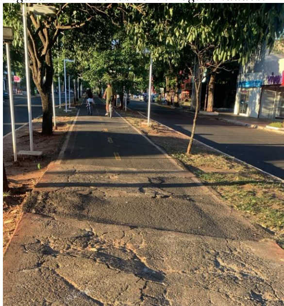
Figura 26 – Trechos com irregularidades.
