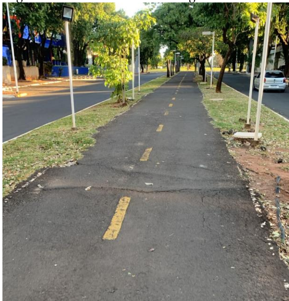
Figura 13 – Trechos com irregularidades.
