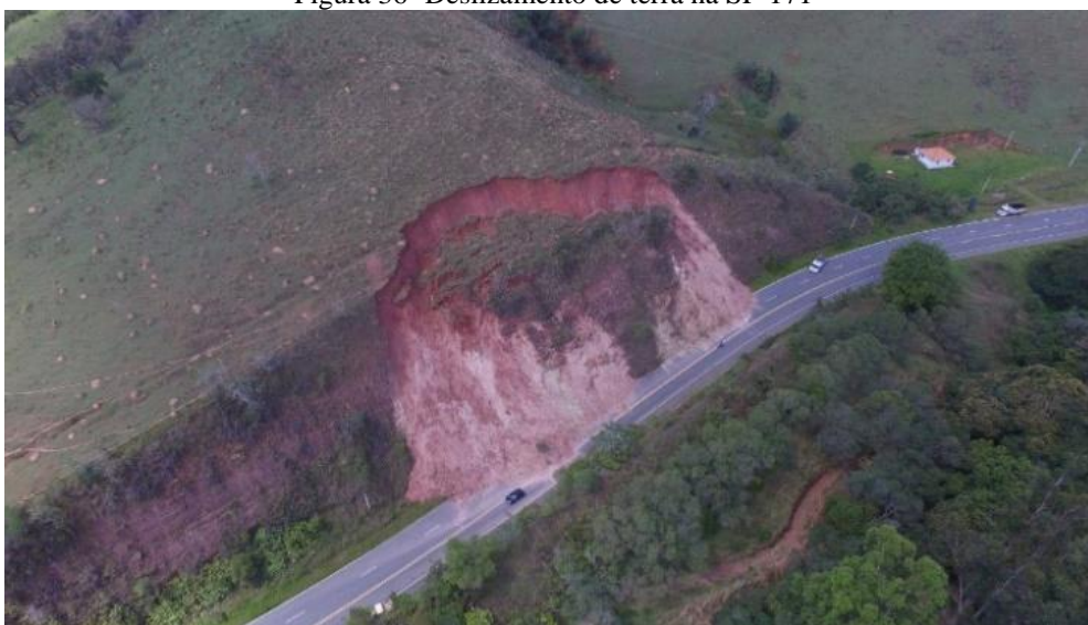
Figura 36- Deslizamento de terra na SP-171
