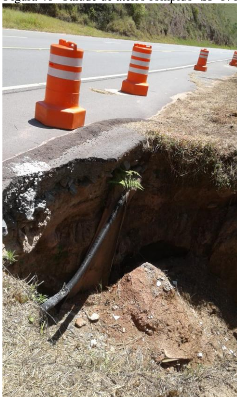
Figura 40- Talude de aterro rompido- SP-171
