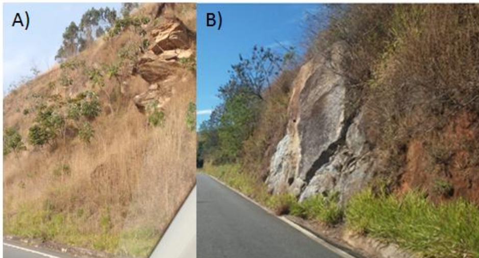
Figura 35- A) Bloco de rocha. B) Rocha solta instável
