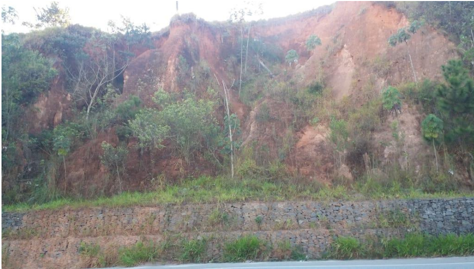
Figura 34- Sistema de drenagem comprometido devido a erosão.
