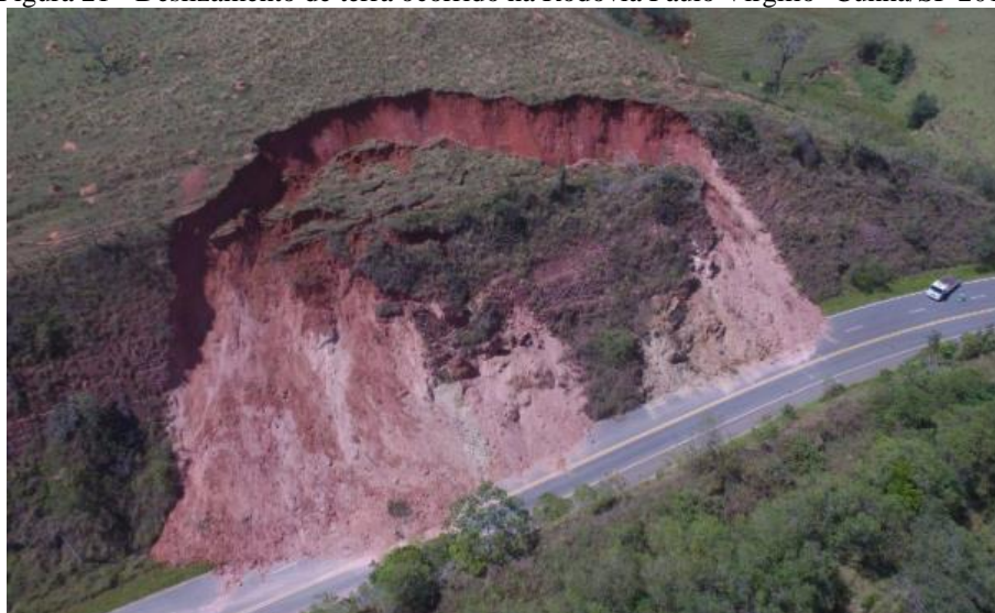
Figura 21 - Deslizamento de terra ocorrido na Rodovia Paulo Virgílio- Cunha/SP 2017
