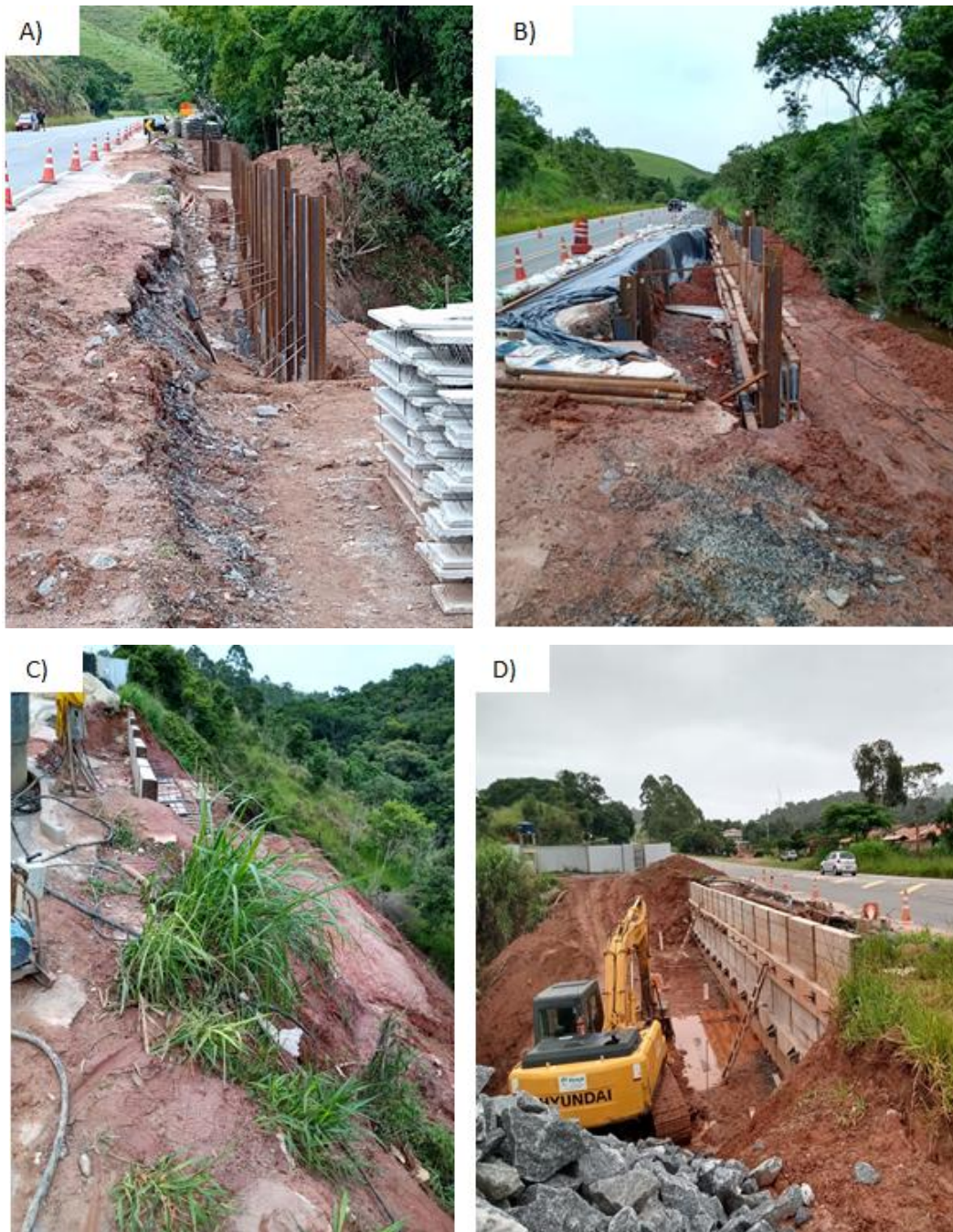
Figura 41- Escorregamentos em taludes de aterro na SP-171
