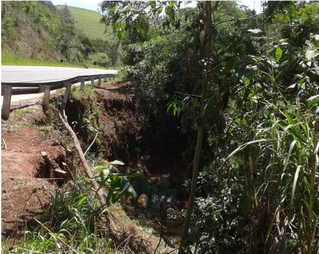
Figura 5- Ruptura de talude de aterro na SP-171 - Cunha/SP-2019.
