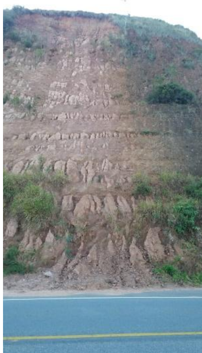
Figura 32- Talude com processo ativo de erosão.
