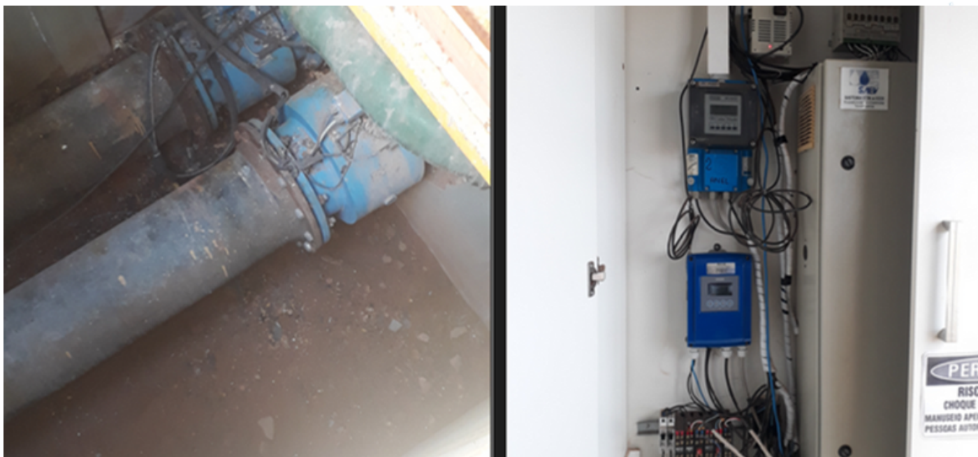
Figura 11 - Macromedidor eletromagnético empregado pelo Saev de Votuporanga -SP
