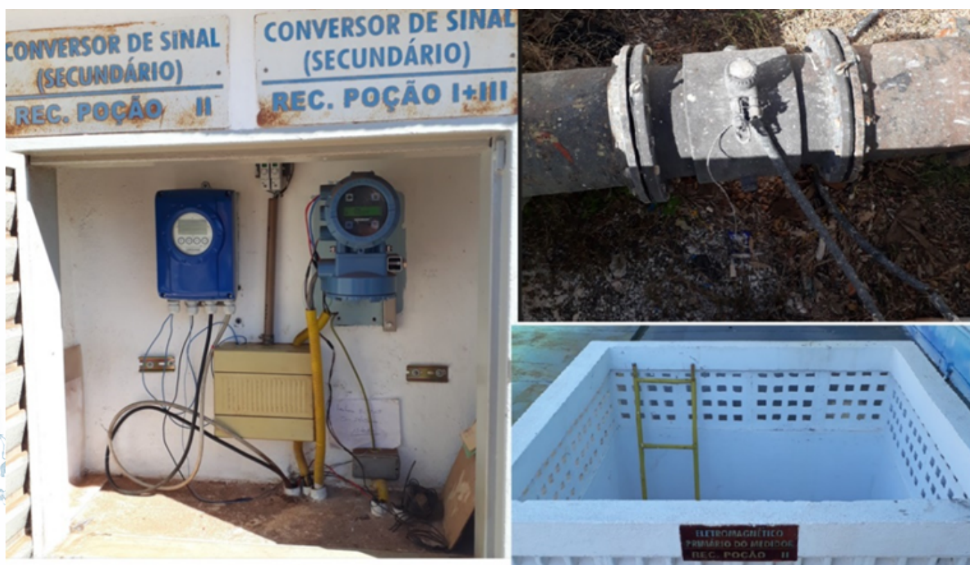
Figura 12 - Macromedidor eletromagnético utilizado pela Sabesp de Fernandópolis - SP
