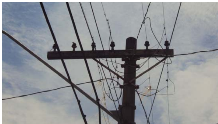
Figura 1 – Poste de concreto armado com cruzeta de madeira sustentando seis isoladores cerâmicos tipo castanha.
