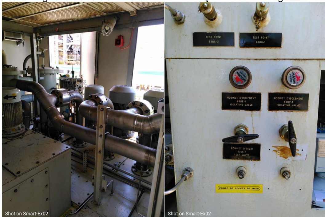
Figura 7 – Módulo e central de lubrificação da turbina a gás
