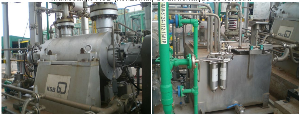
Figura 9 – Unidade de Lubrificação Forçada (ULF) da bomba centrífuga de multiestágio KSB (horizontal) de alimentação de caldeira
