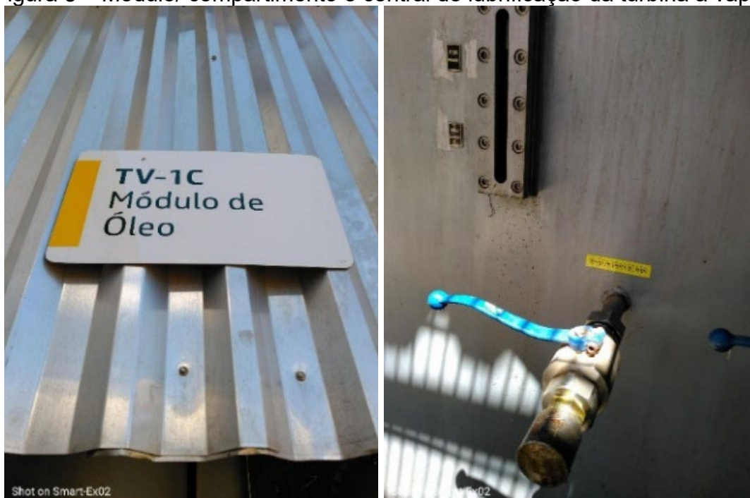
Figura 8 – Módulo/ compartimento e central de lubrificação da turbina a vapor
