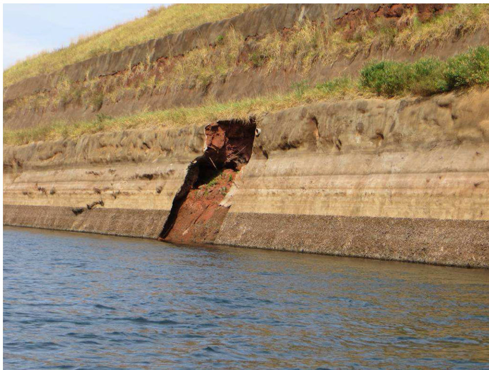
Figura 5- Erosão na lateral do Canal Pereira Barreto
