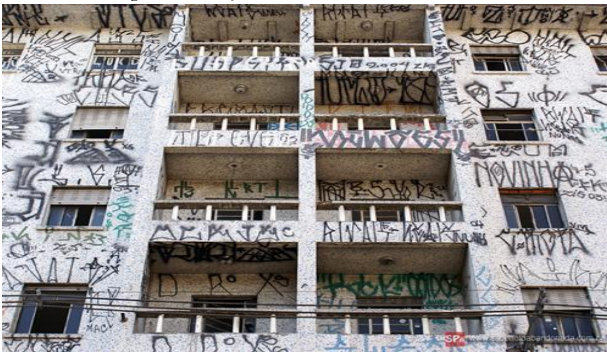
Figura 12 – Pixações em edifício no centro de São Paulo
