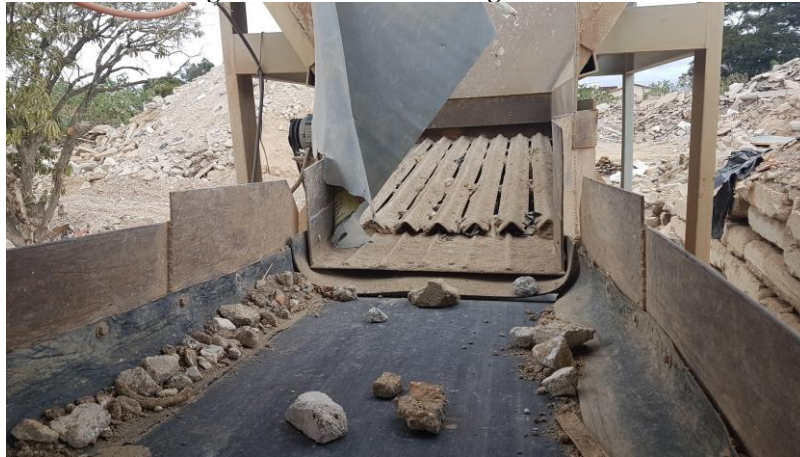
Figura 11 - Esteira de Triagem de RCC
