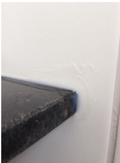
Figura 53: Silicone em excesso no acabamento
