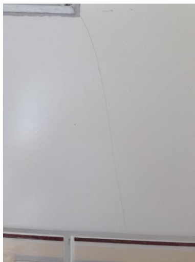
Figura 41: Peça trincada próxima à esquadria
