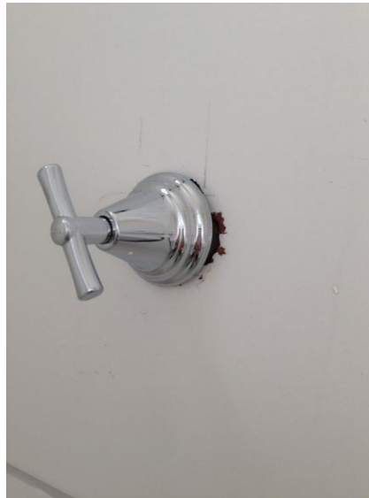
Figura 43: Peça mal recortada para colocação do metal
