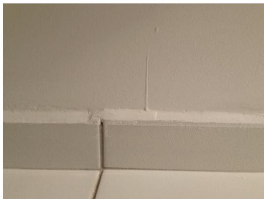
Figura 39: Respingo de tinta entre parede e rodapé cerâmico
