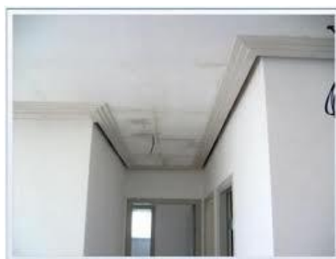
Figura 17: Pintura com mancha no teto
