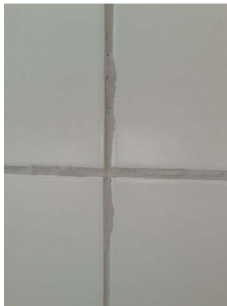
Figura 44: Rejunte em excesso cobrindo falhas deixadas pelas peças lascadas
