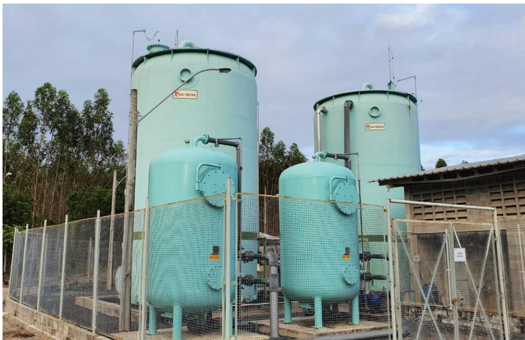
Figura 13 - Sistema de Cloração da Água de Irrigação (SCAI)
