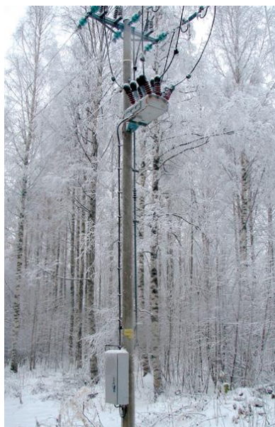
Figura 6 – Religador automático e cabine de controle e comunicações
