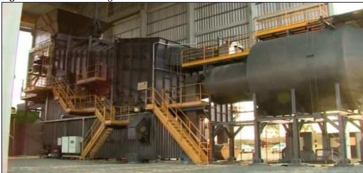
Figura 8 - Gaseificador de grelhas móveis de Mafra/SC
