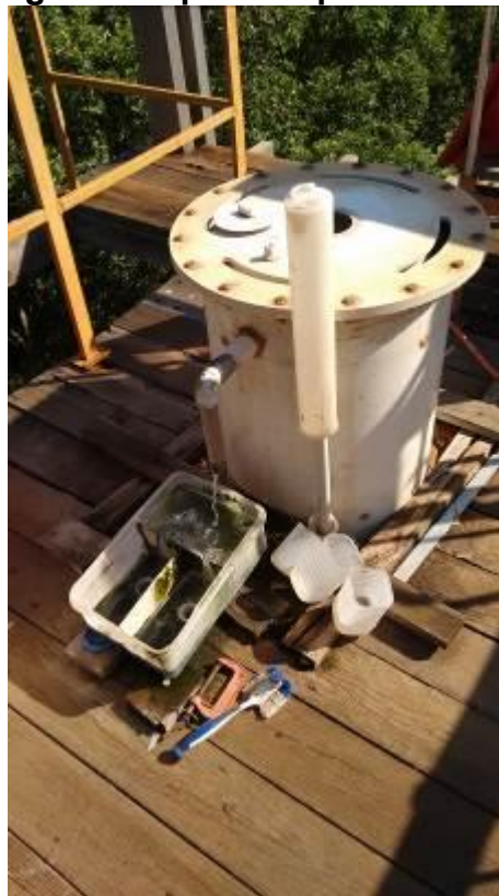
Figura 12 - Fotografia da parte superior do RUC já instalado
