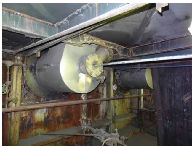
Figura 5.8 – Vista frontal do queimador – lado externo do forno.
