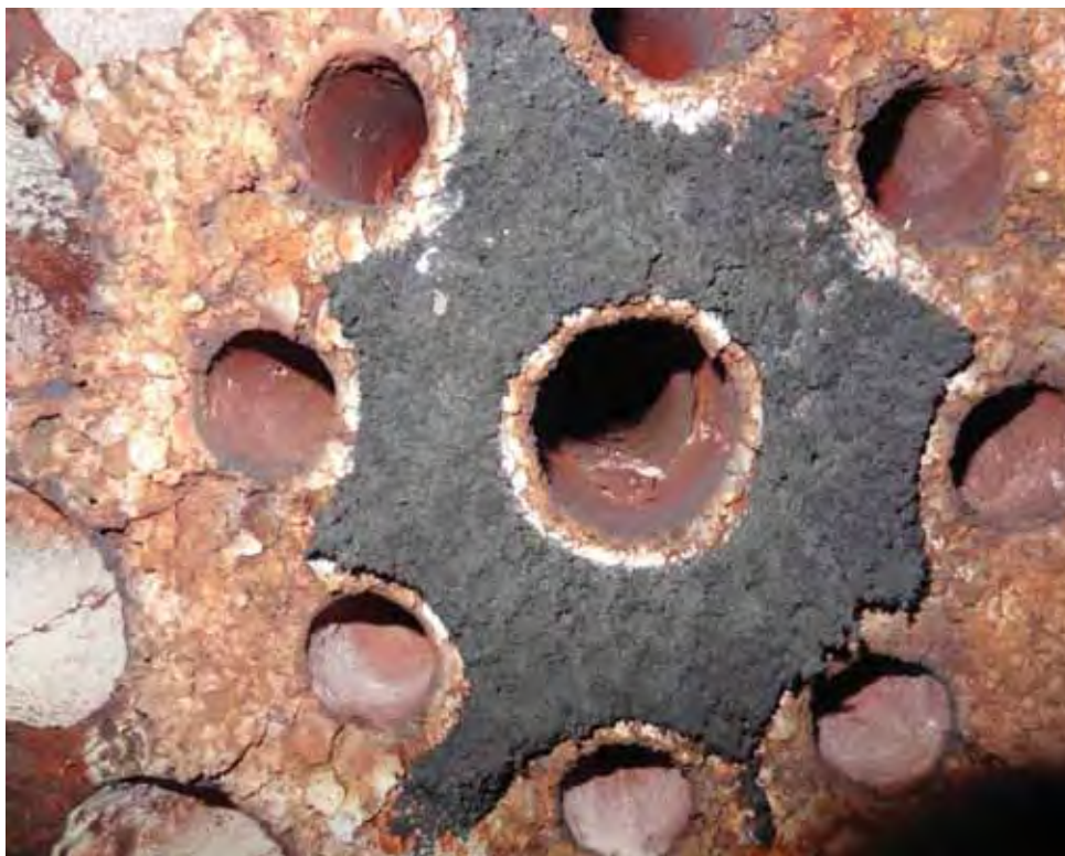
Figura 6.33 – Deposição de carbono devido à fuligem na saída de um queimador da zona 1 do forno de reaquecimento.
