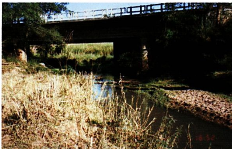
Figura 27 – Local do ponto de coleta 3, águas com coloração acinzentada no início da campanha de monitoramento.
