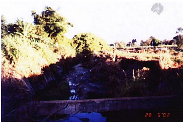
Figura 18 – Sinais de degradação visíveis, foto à jusante do local do ponto de coleta 2.
