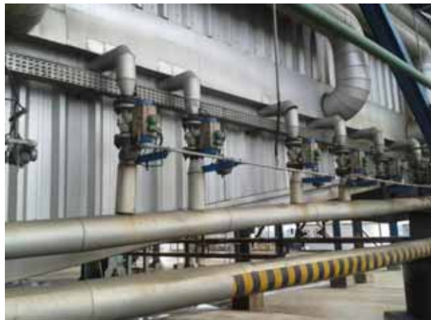
Figura 62: Sopradores de grelha
