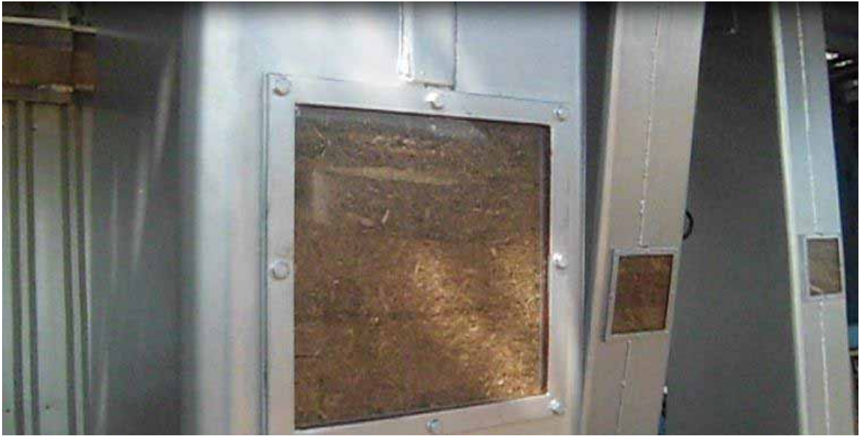
Figura 45: Selagem perfeita (note que não há entrada de ar falso na fornalha)
