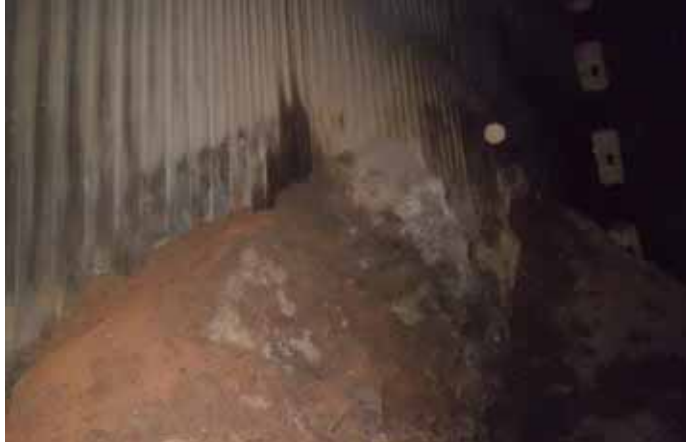
Figura 71: Depósito de areia + cinzas nas paredes dos tubos no interior da caldeira
