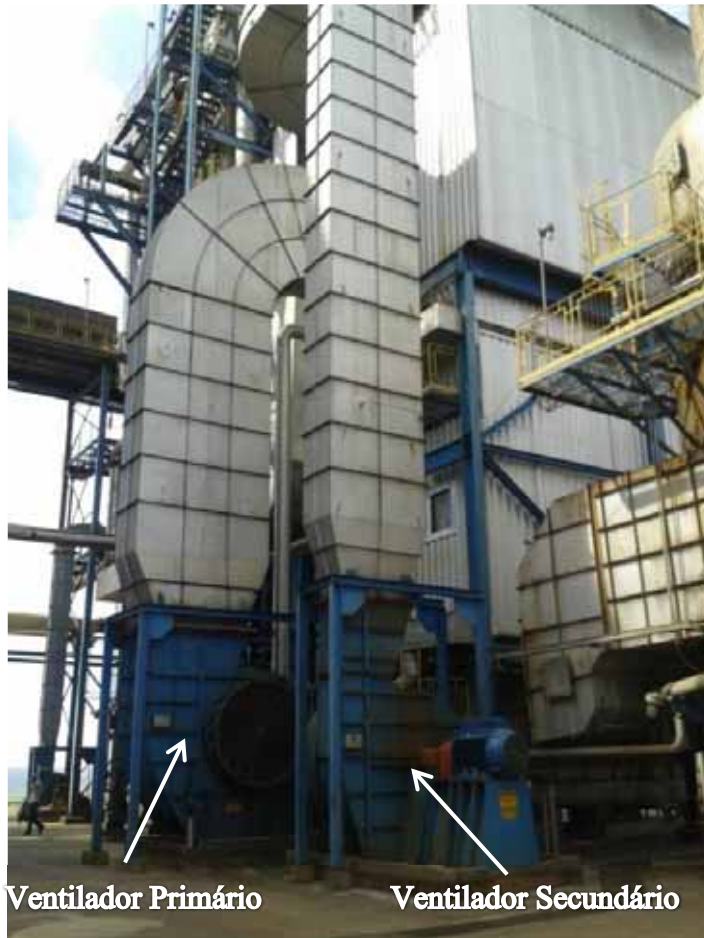
Figura 30: Ventiladores primário e secundário
