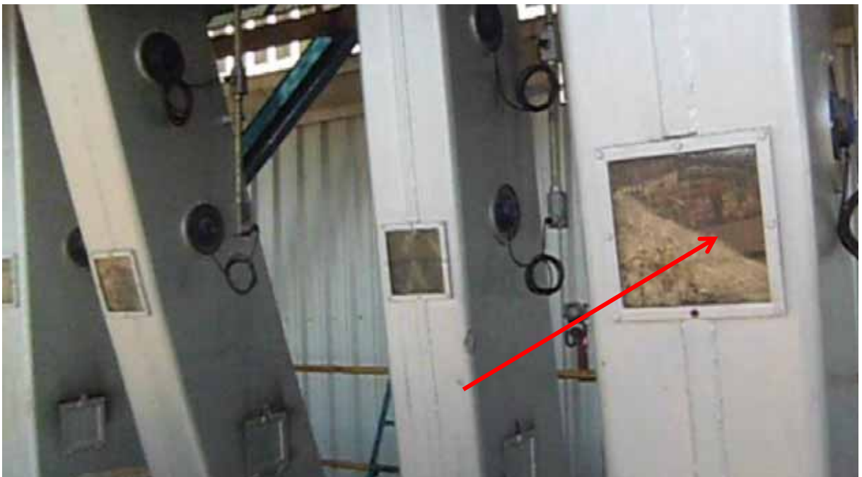
Figura 46: Selagem deficiente, entrada de ar falso para o interior da fornalha
