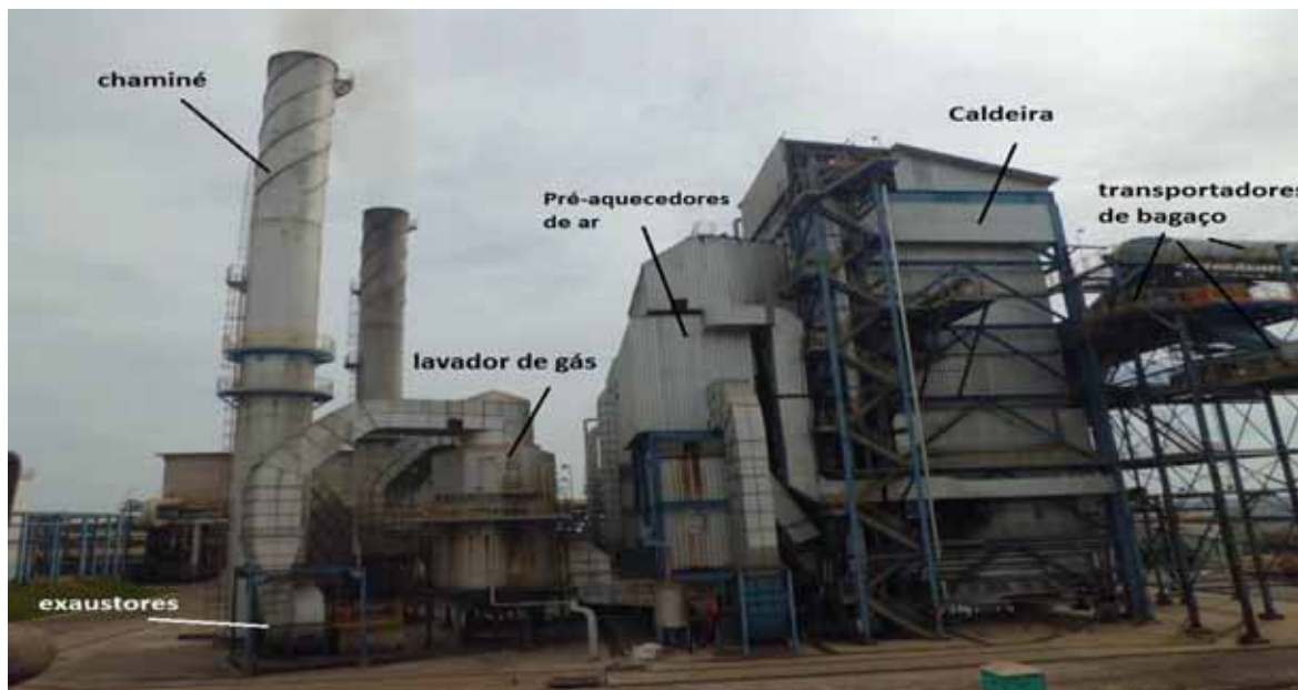
Figura 27: Vista da área de Caldeira da UTE Brotas.
