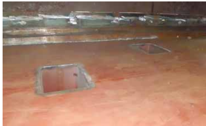
Figura 42: Entrada dos dosadores de biomassa na esteira TT-01.
