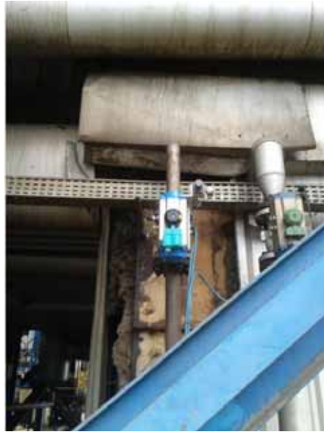
Figura 61: Novo soprador para limpeza de grelhas
