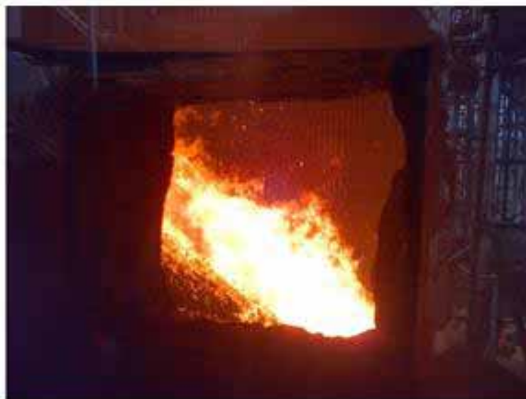
Figura 53: Deposição de material sobre a grelha.
