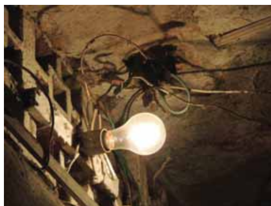
Figura 8 - Instalação Elétrica em um cortiço Fonte: COSTA, 2012.
