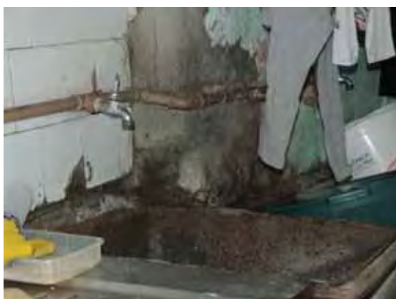
Figura 7 - Instalação Hidráulica em um cortiço Fonte: COSTA, 2012.
