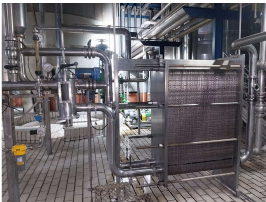
Figura 7 – Trocador de Calor para resfriamento do mosto.
