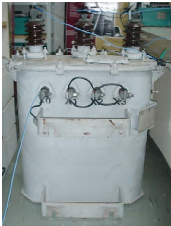
Figura 2.04 – Transformador de 15 kVA utilizado no experimento.
