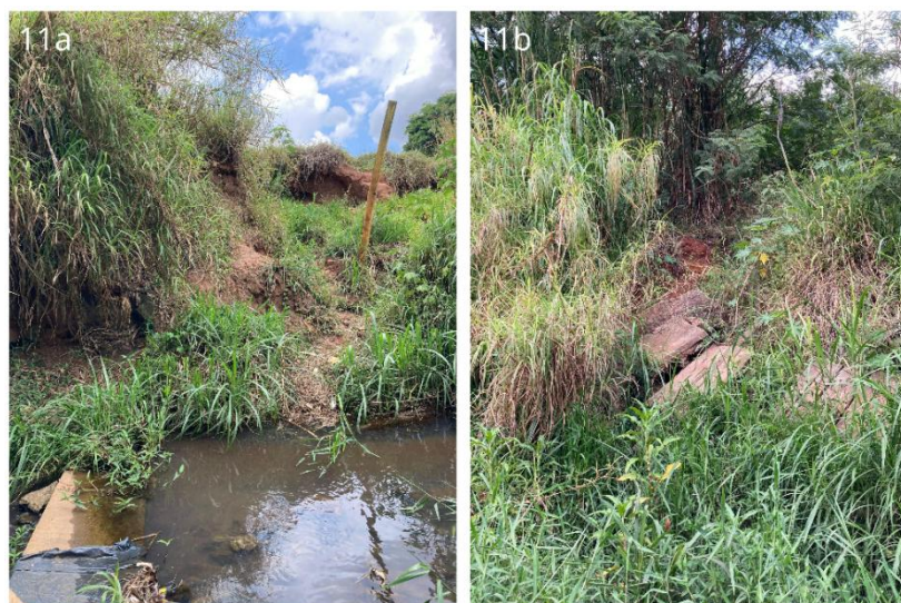
Figura 11. Fragmentos de ponte que desabou sobre o rio e capim-napiê crescendo em suas margens, ponto A, Rio Lavapés. 11a) Margem esquerda. 11b) Margem direita.
