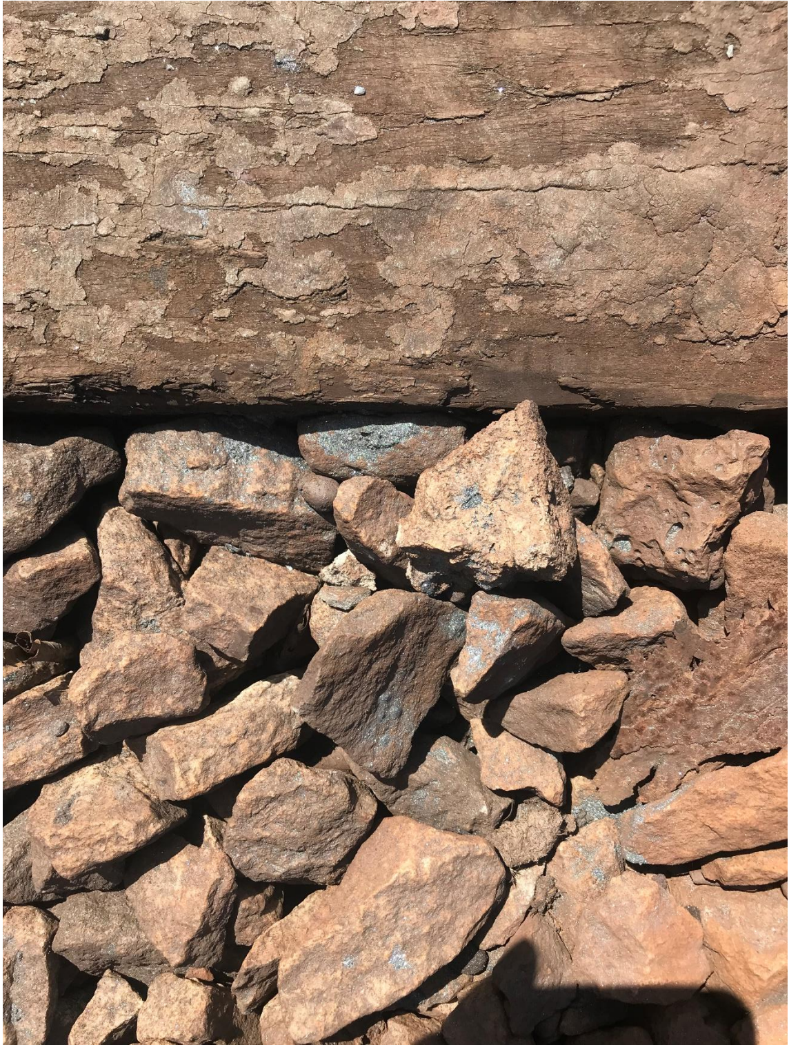
Figura 1 - Dormentes dos trilhos com partículas de minério de ferro em pó, caídas dos vagões dos trens de carga.
