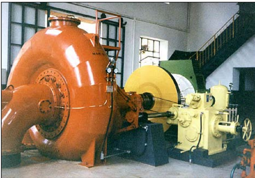
Figura 3 – Foto de uma Unidade Geradora com turbina Francis
