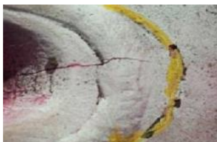
Figura 30: Trinca em uma junta soldada.
