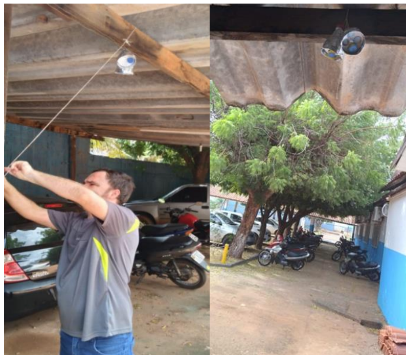
Figura 25: Instalação do amostrador na escola Daniel. Fonte: Autor.
