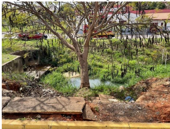
Figura 38. Fotografia de degradação na margem do canal Chiquinho Quadro
