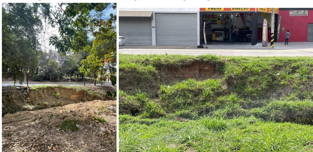
Figuras 39 e 40. Sinais de solapamento córrego Chiquinho-Quadros
