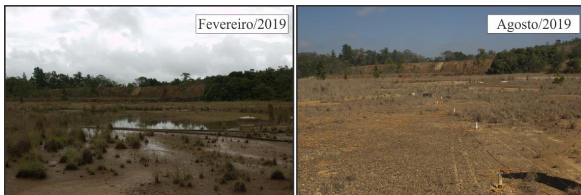
Figura 35. Contraste entre o acúmulo de água no BF 08 durante período chuvoso (Fevereiro/2019) e a completa drenagem da água para o interior da pilha (Agosto/2019)
