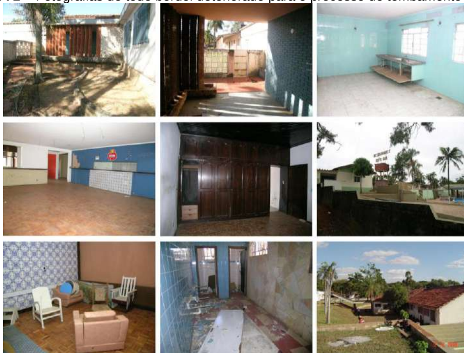
FIGURA 71 - Fotografias de todo bordel deteriorado para o processo de tombamento em 2006.
