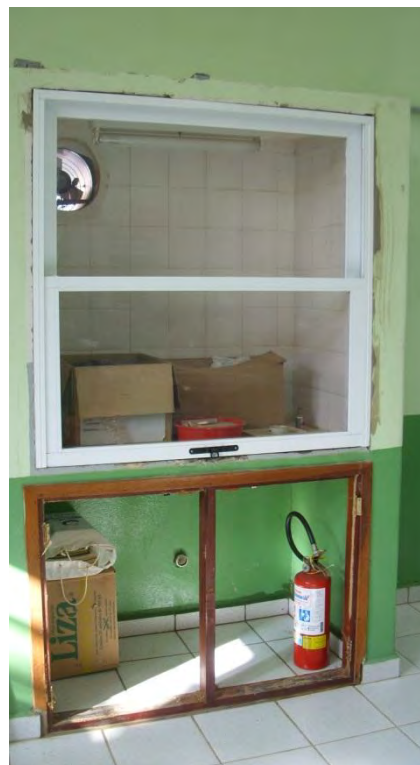
Foto 8: Detalhe da Capela do laboratório da escola 3. O exaustor no canto esquerdo superior da foto jogaria o ar contaminado para a entrada da escola, onde há a passagem de estudantes, funcionários e professores. Além disso, observamos que o extintor não está localizado em local adequado e com sinalização que evite obstrução de acesso, para o caso de incêndio.
