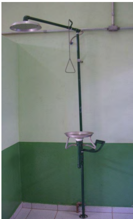
Foto 7: Detalhe do chuveiro de segurança na escola 3.
