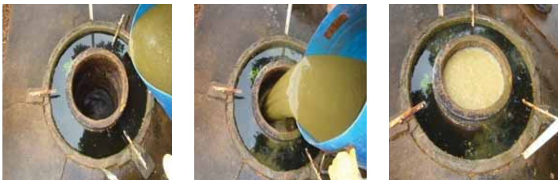
Figura 6. Abastecimento do biodigestor batelada
