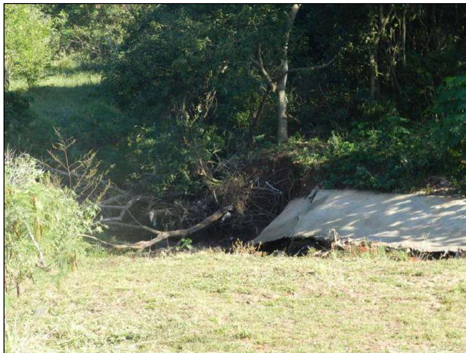
Foto 16. Ruptura do dispositivo e queda de árvores.
