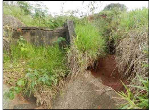
Foto 12. Canal aberto com erosão lateral.
