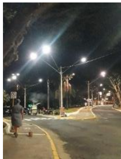
Figura 94 - Iluminação na Rua da Praça Antônio José Miziara.
