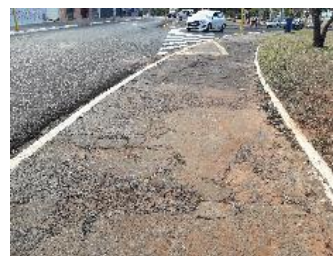
Figura 79 - Buracos na calçada da rua Praça Antônio José Miziara.
