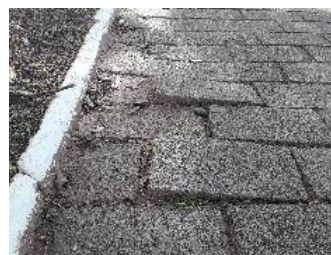
Figura 77 - Pisos levantados pelas raízes das árvores na calçada da Av. Nações Unidas.
