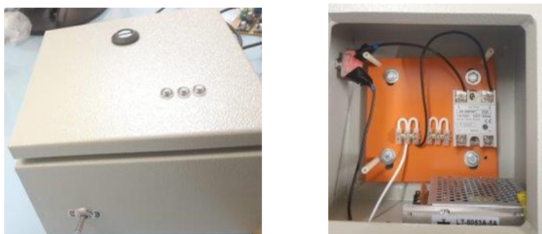
Figura 18 – Quadro metálico para proteção da placa de circuito impresso e componentes
