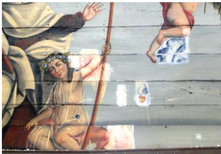
Figura 243. Detalhe de prospecções realizadas no teto da capela-mor da Igreja do Carmo de Itu, onde se vê que a pintura de Jesuíno do final do século XVIII ainda existe e parece ter muito mais elementos do que se vê na atualidade. Foto: E. Murayama, 2014.
