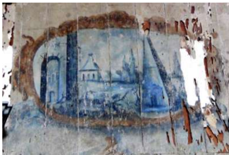
Figura 103. Detalhe de painel parietal representando paisagem com pirâmide, provavelmente cópia de gravura europeia. O tabuado estava bem deteriorado, percebendo-se a ação de cupins (2014). Foto: E. Murayama.
