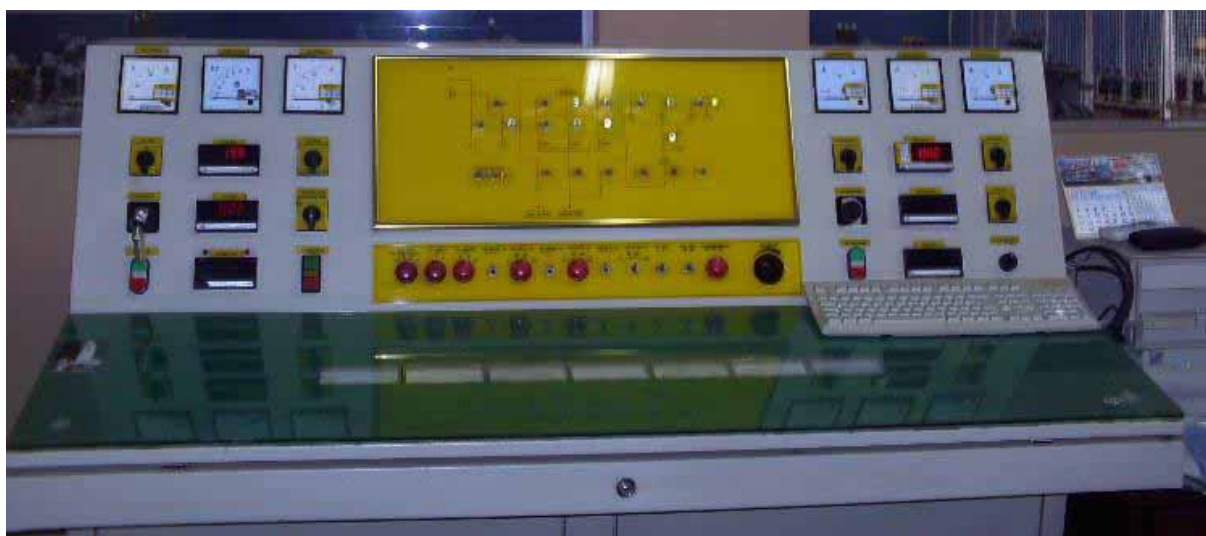
Figura 4.19: Bancada de testes da empresa reformadora
