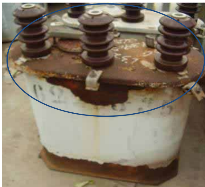
Figura 4.6: Transformador em acelerado processo de corrosão.
