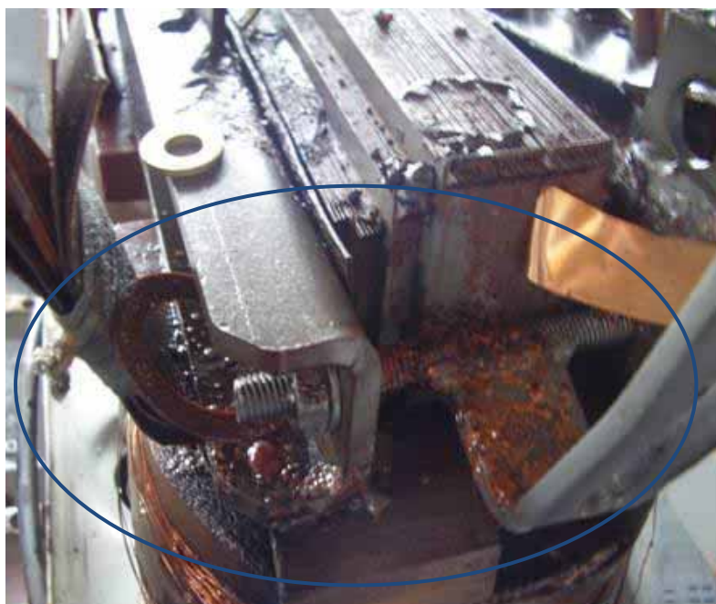
Figura 4.4: Detalhe do transformador retirado de operação por infiltração de água.
