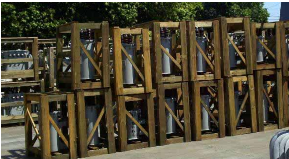
Figura 4.21: Transformadores embalados e prontos para utilização.
