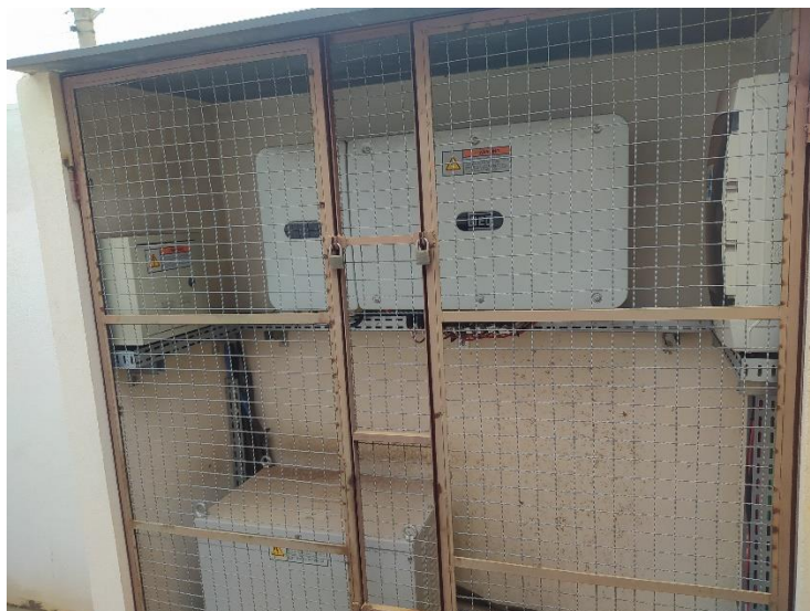
Figura 13 - Inversor do Sistema Fotovoltaico da Unidade B.
