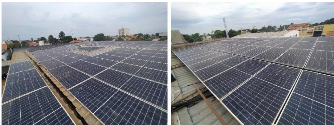
Figura 10 - Módulos do Sistema Fotovoltaico da Unidade A.
