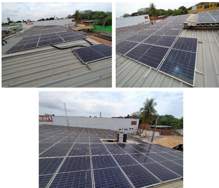
Figura 12 - Módulos do Sistema Fotovoltaico da Unidade B.
