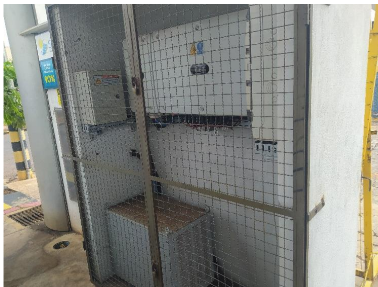
Figura 11 - Inversor do Sistema Fotovoltaico da Unidade A.
