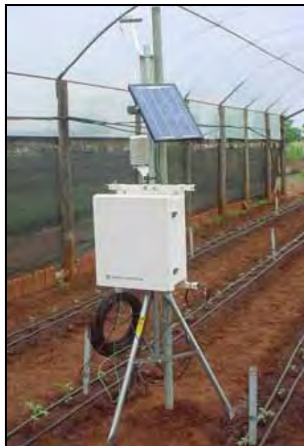
FIGURA 2 - Vista da estação climatológica automática utilizada no experimento. Ilha Solteira (SP), 2006.
