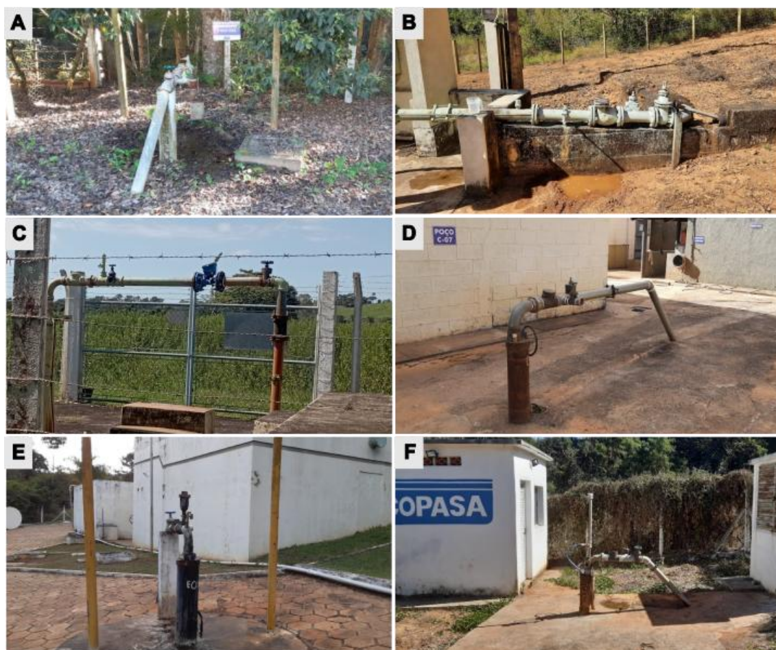
Figura 12 – Poços de abastecimento da Copasa. A. Ponto GW-01, em São Roque de Minas/MG. B. Ponto GW-02, em Vargem Bonita/MG. C. Ponto GW-05, em Tapirai/MG. D. Ponto GW-06, em Córrego Danta/MG. F. Ponto GW-07, em Luz/MG. G. Ponto GW-11, em Arcos/MG. Fonte: Elaborado pela autora.
