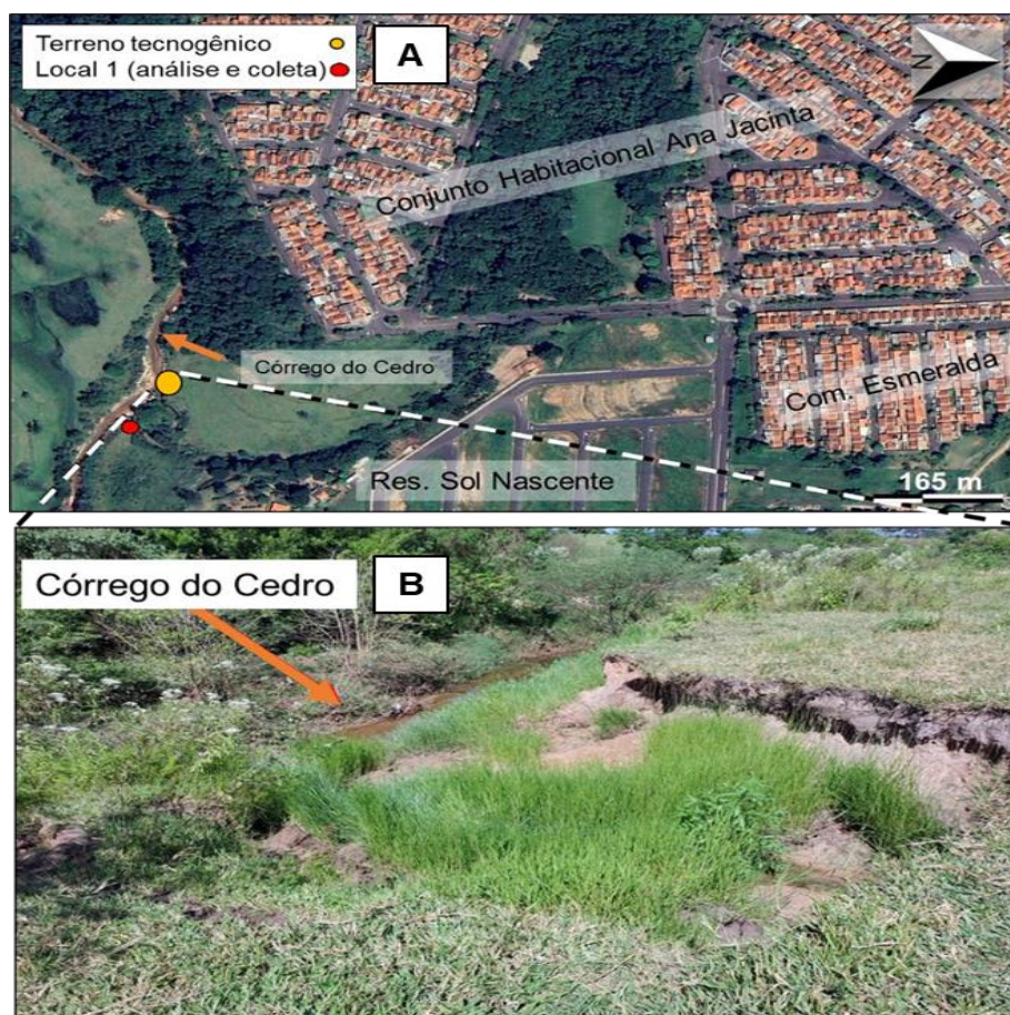
Figura 67- Terreno tecnogênico (terraço) em processo de solapamento localizado próximo do Local 1.
