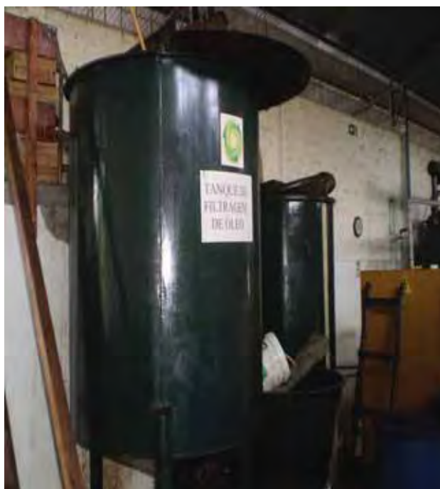
Figura 7 - Tanque de filtragem de óleo (CHEMIGAL)
