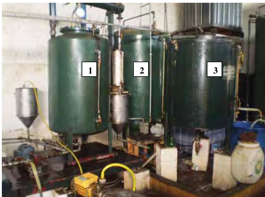
Figura 8 – Tanque de armazenamento (1), tanque de processamento (2) e tanque de decantação (3).
