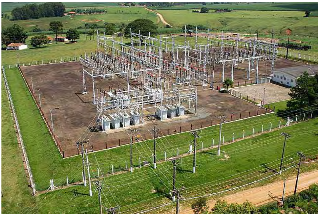
Figura 6 - Subestação de 138 kV (fonte: ISA CTEEP, 2008).
