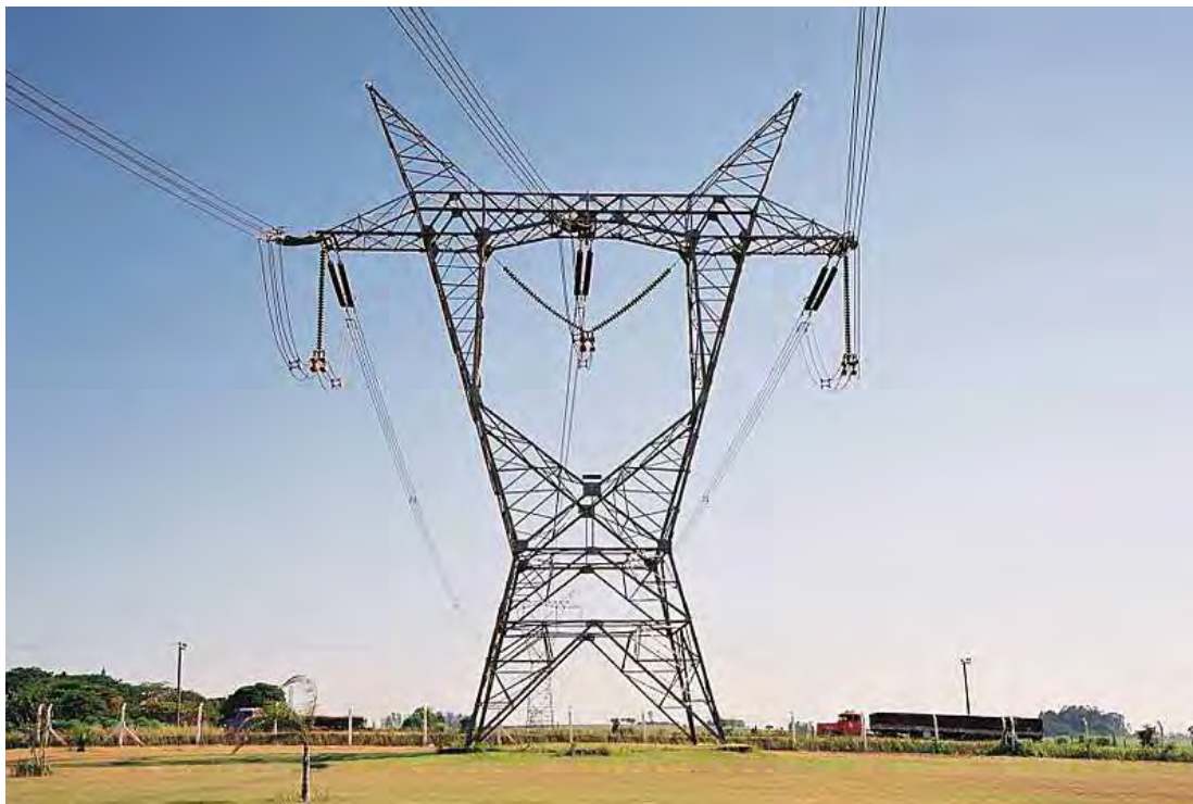
Figura 7 - Torre de linha de transmissão de 440 kV (fonte: ISA CTEEP, 2008).
