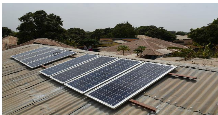
Figura 6: Sistema fotovoltaico caseiro instalado pela FRES.
