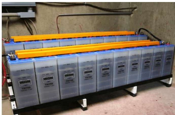
Figura 17: Baterias de níquel sólido instalados em um sistema fotovoltaico
